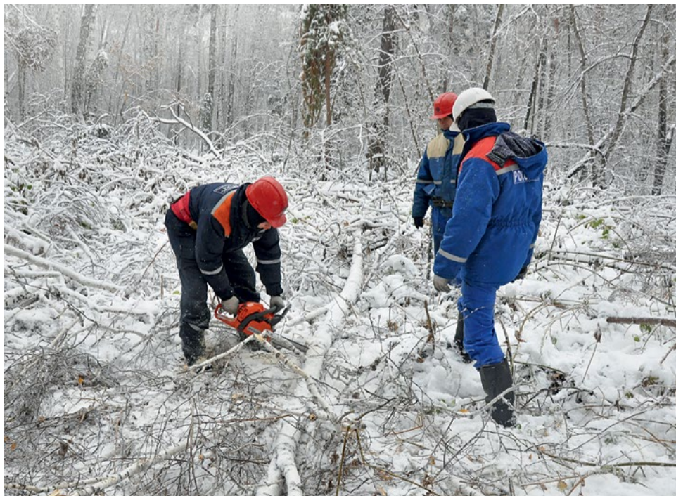
Работники МРСК Урала расчищают завалы, образовавшиеся на просеках ЛЭП, после ледяного дождя
